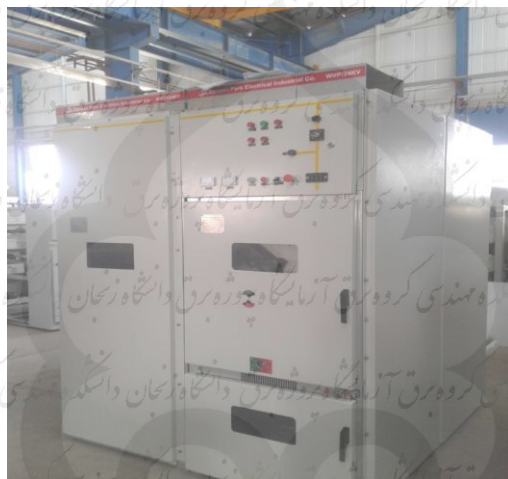
شکل (۱-۴) : تابلو تمام بسته ایستاده
