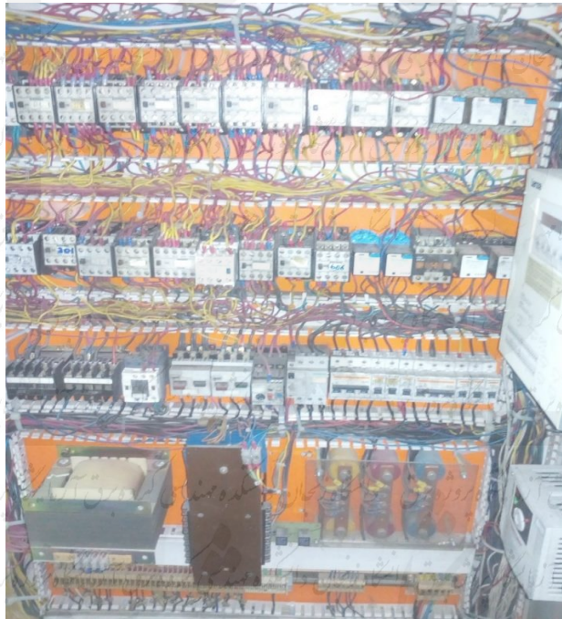
تابلو برق قدیمی دستگاه اشتانس ری
